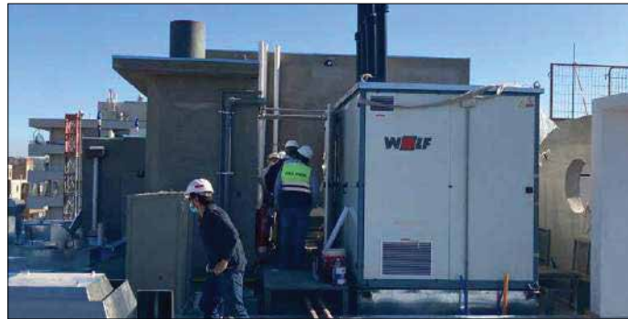
Sala de calderas prefabricadas alemanas de condensación Wolf, que producen ahorro de energía.
